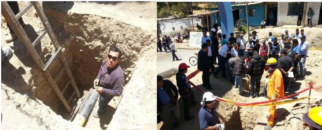
No es cierto que los pobladores de Cajacay “desenterraron cien metros de tubería”. No fueron más cinco metros. Tampoco es verdad que “cortaron parcialmente el cable de fibra óptica”.
